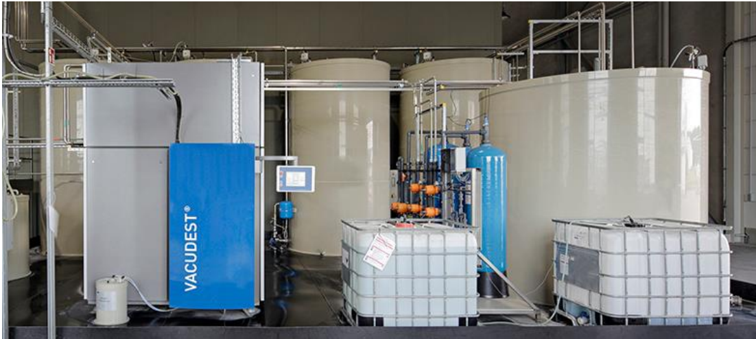
Abbildung 6: Implementierung einer VACUDEST Vakuumdestillationssystem bei der Firma ZINKPOWER Coating Schoppsdorf. Bildquelle: [17].
